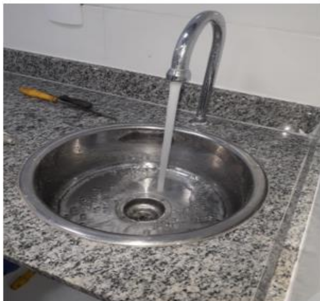
Dia 14/09/2022 - Desentupimento de pia em clínica localizada no 1º (primeiro) andar do prédio da Faculdade de Odontologia no Campus Valonguinho.
