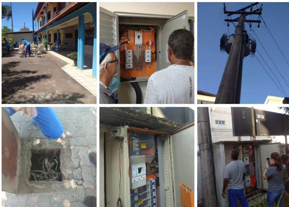
Acompanhamento e fiscalização das atividades de manutenção de subestações e quadros elétricos em Rio das ostras, Macaé e Campos, em 16/03/2022, pela equipe da Superintendência de Operações e Manutenção.
