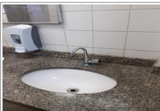
Trocada torneira do banheiro masculino do Mequinho.
