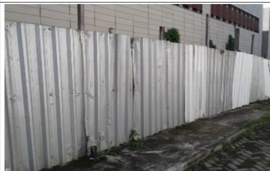
Tapume da obra do Instituto da Praia Vermelha recolocado. O mesmo caiu devido aos fortes ventos da noite do dia 30/01/2020.
